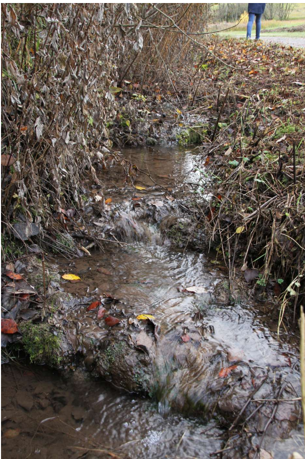
Abb. 4.1b.2: Tuffbarrieren im Ablaufgraben
